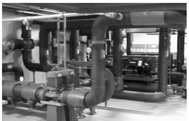
Kjøleanlegget til superdatamaskinene.
